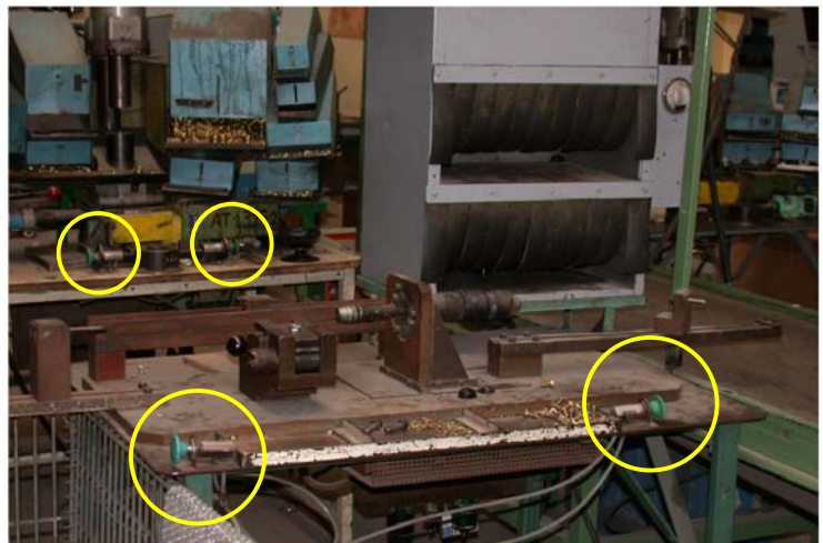
Postes des divers (commandes bimanuelles encerclées)
