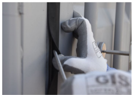
Photo 1. Ecartement du joint extérieur
