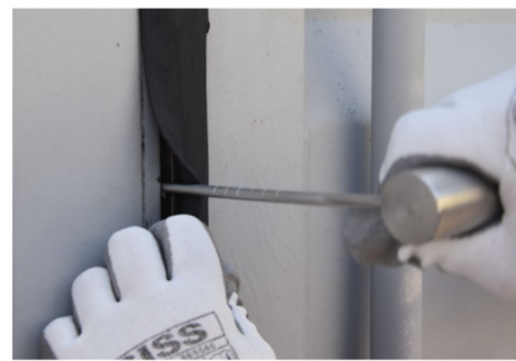
Photo 2. Glissement du joint entre la porte et le joint extérieur
