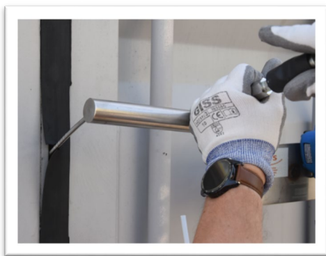
Photo 3. Connexion de la pompe.
