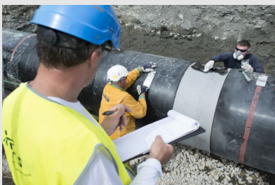
© Grégoire Maisonneuve pour l'INRS/2017 Utilisation de résines époxy lors de la construction d'un gazoduc
