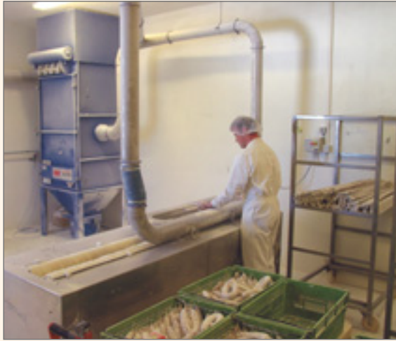
Fig. 5 : Une fabrique de saucissons traditionnels équipée d'un système de ventilation.
