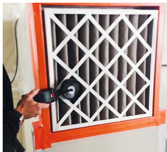
↑ FIGURE 1 Préfiltre au niveau d'un extracteur [2].
