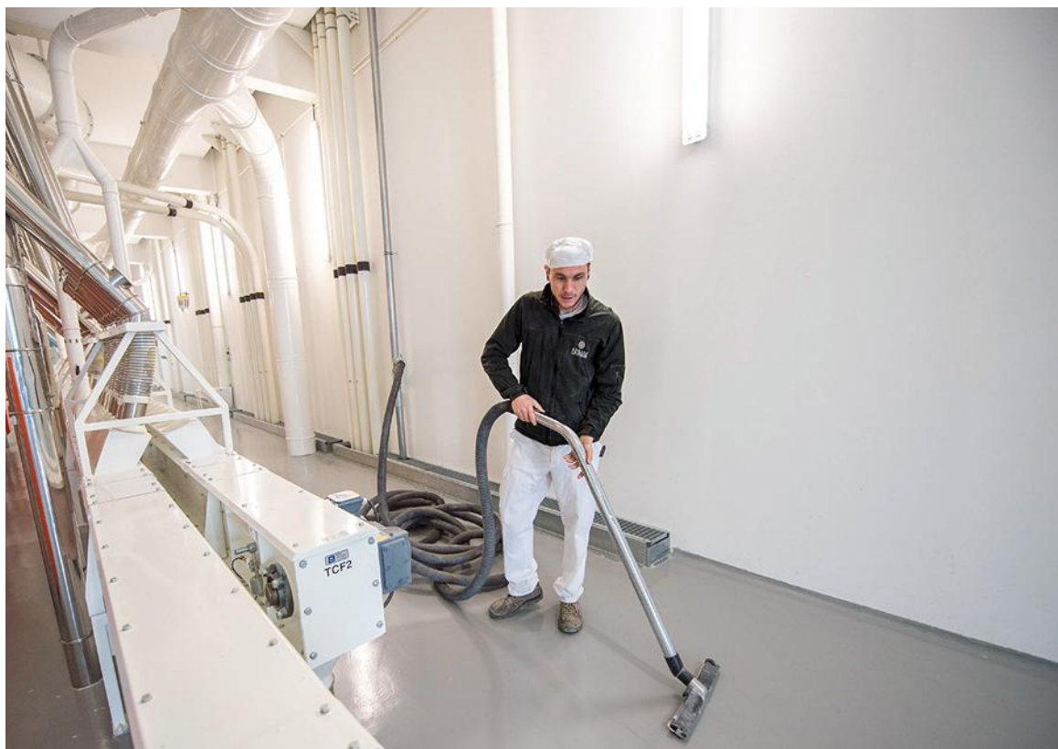
Meunerie en Bourgogne. Appareil de nettoyage relié à un système d'aspiration centralisé.
