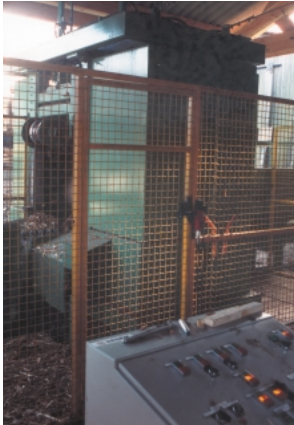
Fig. 17. Porte interverrouillée permettant l'accès à l'intérieur du site protégé, une fois les éléments mobiles arrêtés
