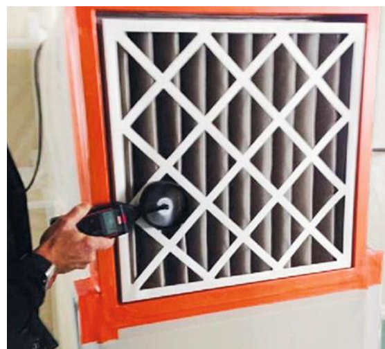
↑ FIGURE 1 Préfiltre au niveau d'un extracteur [2].
