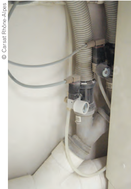
Photo 4. L'asservissement au dispositif de captage
