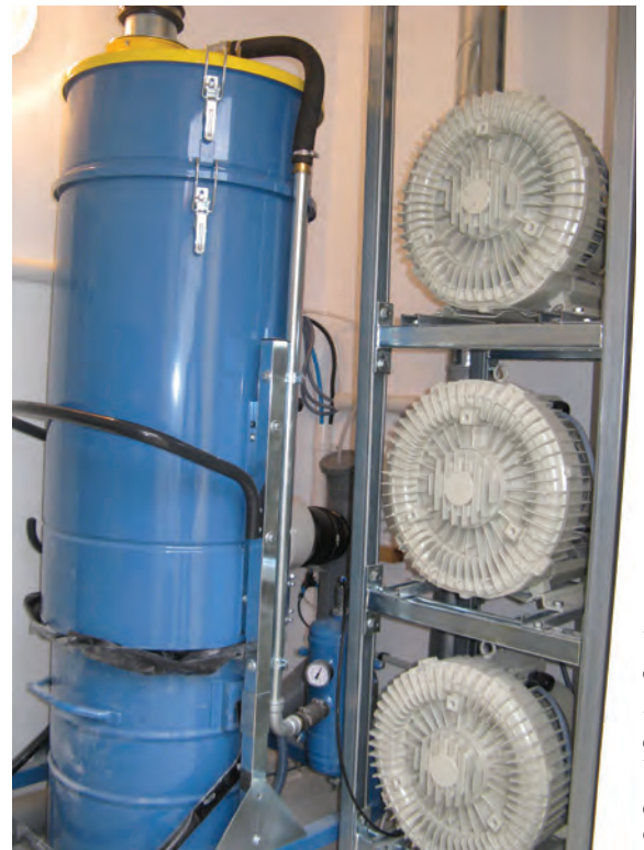
Photo 10. Exemple d'une centrale d'aspiration disposée dans un local isolé
