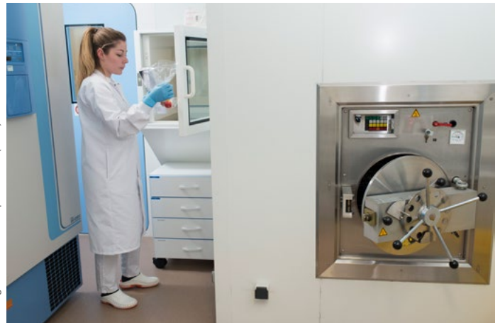
Figure 1. Autoclave à double entrée d'un laboratoire de recherche (confinement de niveau 3).
