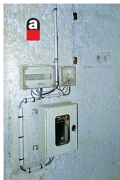
▶ Dans le plâtre amianté ▶
