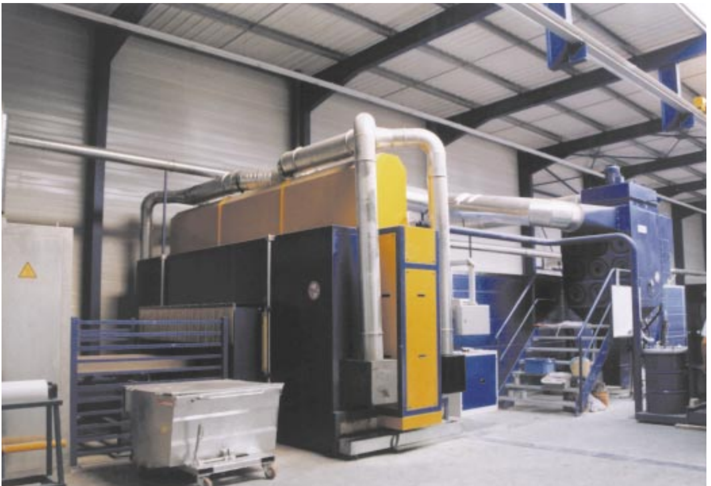
Fig.22. Cabine de peinture automatique. Au second plan, le caisson de filtration avant rejet.
