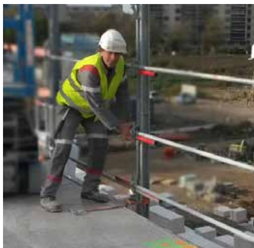
Protections fixées sur dalles
