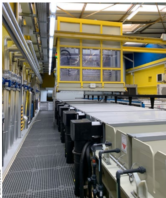
Photo 1. Vue d'ensemble de la ligne automatisée
