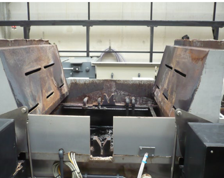
■ Photo 5. Cuve ouverte avec dispositif de captage bilatéral
