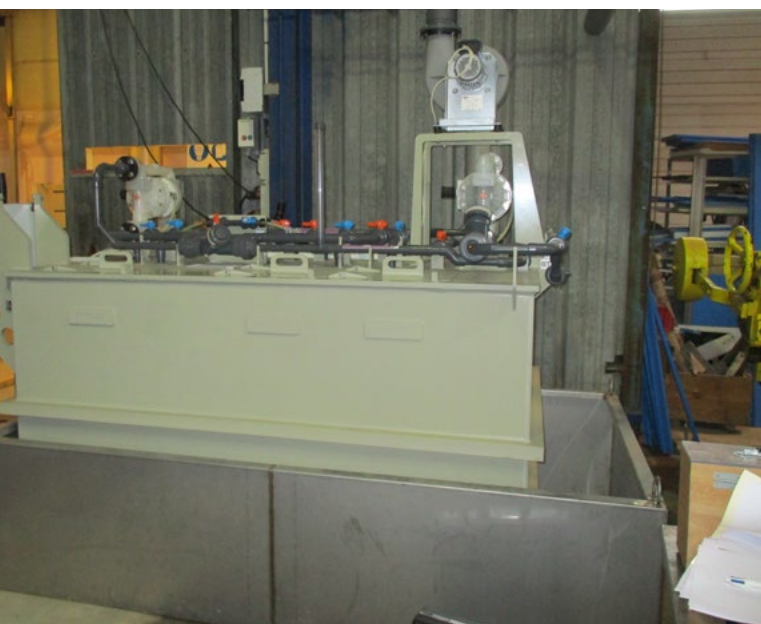
■ Photo 9. Cuve de stockage du décapant et du passivant
